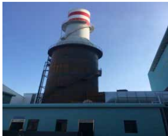
窑炉脱硫除尘系统
